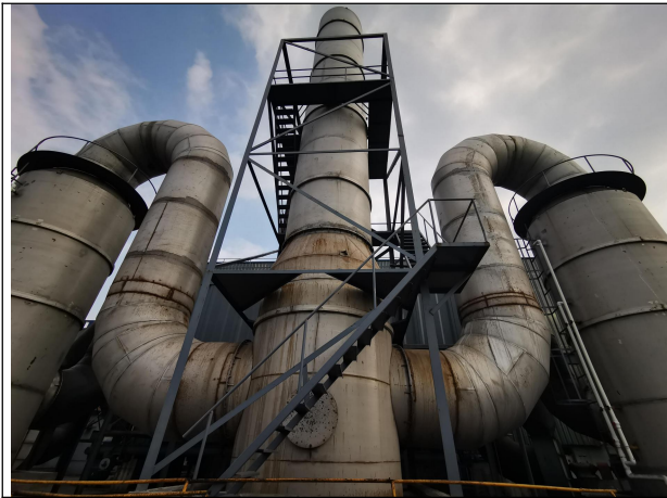
图 5 脱硫塔及熔炼尾气排放口 (DA001)
