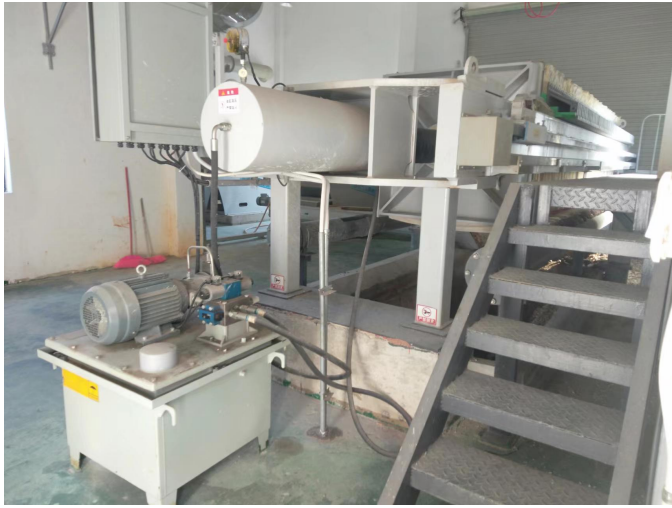
图片 10 污泥浓缩脱水间（板框压滤机）
