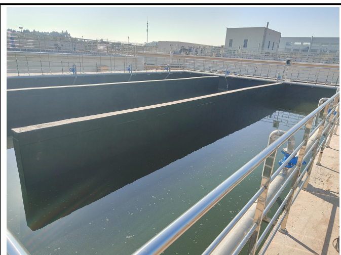
图片 6 芬顿高级氧化池（调试中）
