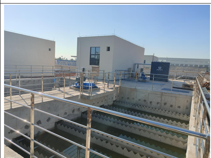
图片 8 超高速多介质沉淀池（调试中）
