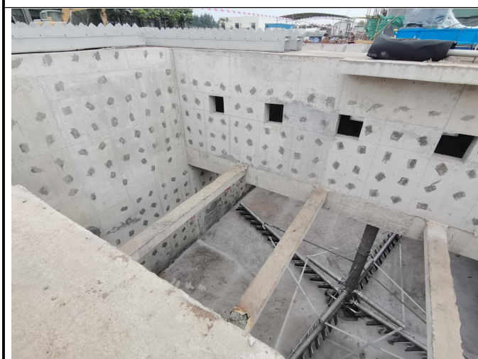
图片 7 超高速多介质沉淀池（空池）
