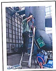
7#发泡炉废气处理后
