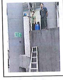
6#压延生产线废气处理后
