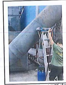
1#、2#、4#、5#开布机、6#-10#表面处理废气处理前
