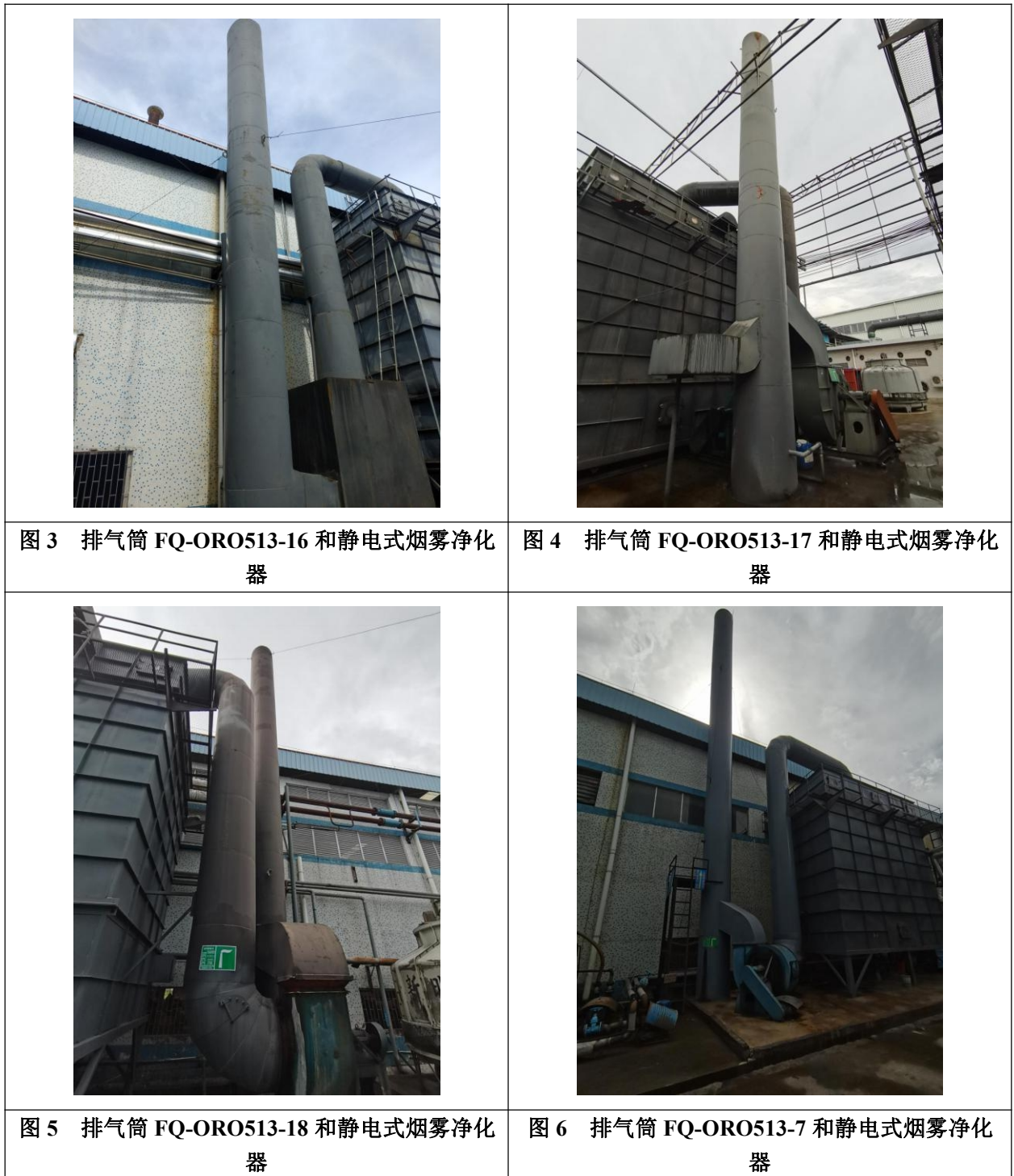
图 4-1 废气治理设施
