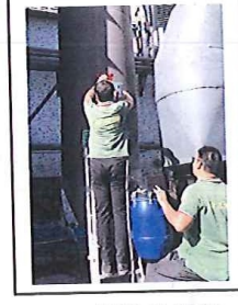
8#发泡炉废气处理后
