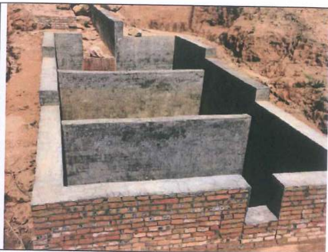
雨水沉淀池及硬底化
